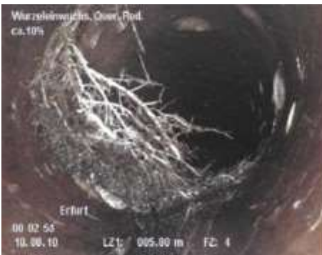
Bild: Wurzeleinwuchs in der Entwässerungsleitung
